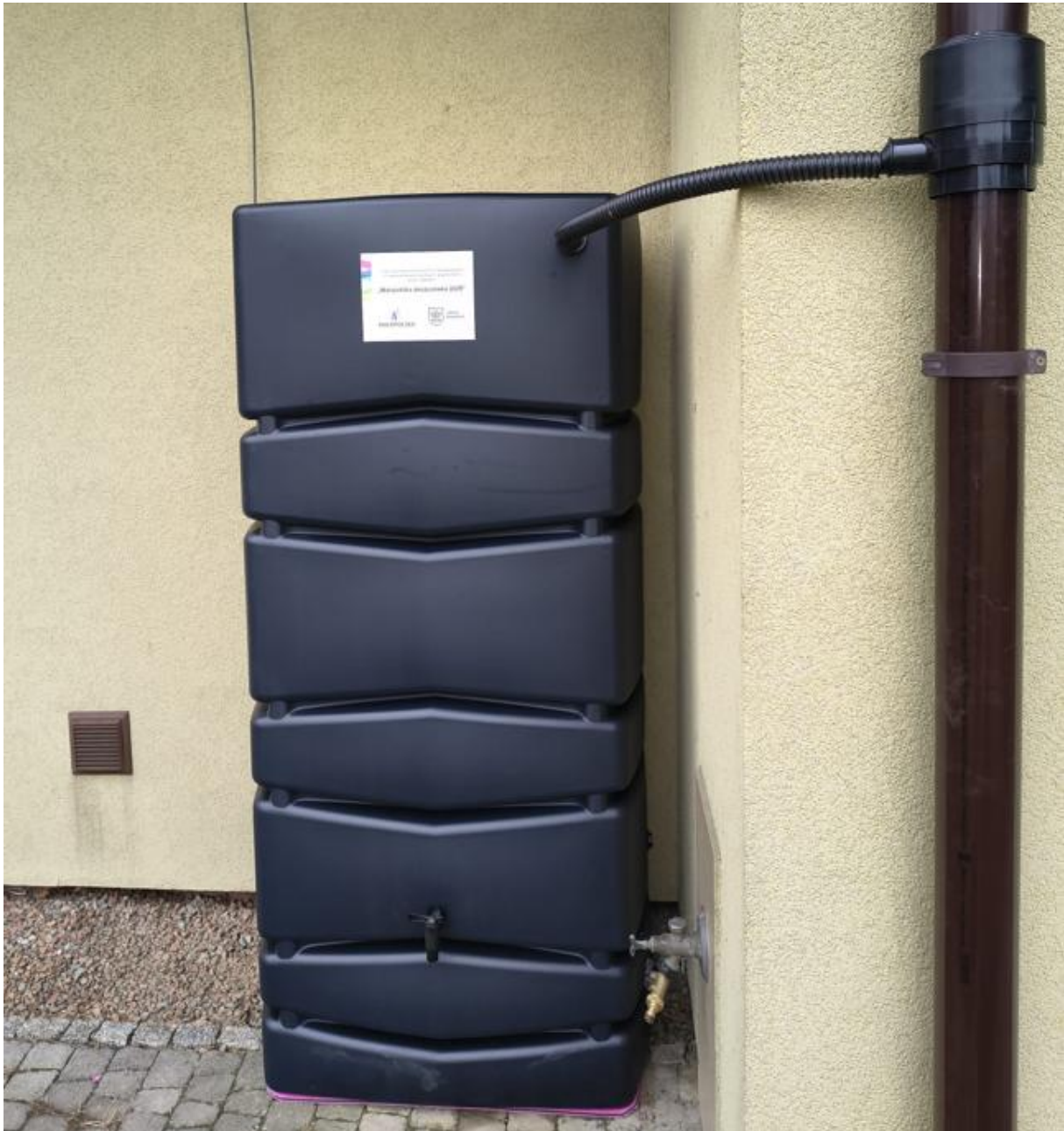
Fot.VI.1. Podłączony zbiornik na wodę opadową
