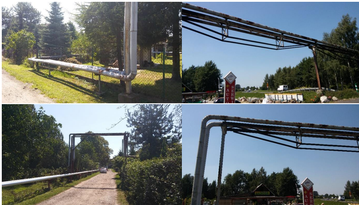
Rysunek 23. Stan techniczny ciepłociągu na terenie Gminy Oświęcim (źródło: Grupa CDE Sp. z o.o.)
